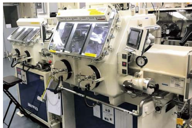
大気非曝露 解体・サンプリング用 グローブボックス
